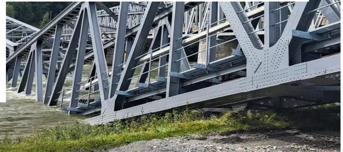
Jernbanebroen over Gudbrandsdalslågen i Ringebu ble ødelagt etter ekstremværet hans. Det får store konsekvenser for togselskapene. Foto: Lars Skjeggstad Kleven / NTB
